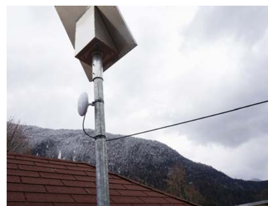
Eine Richtfunkanlage über 500 Meter durch Unken bringt den e-card-Anschluss von der Hausarzt-Ordination in die Impfstation.
